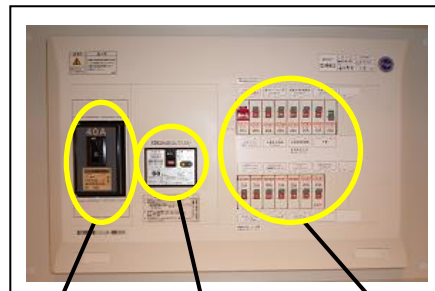
メインブレーカー 漏電ブレーカー 回路ブレーカー
